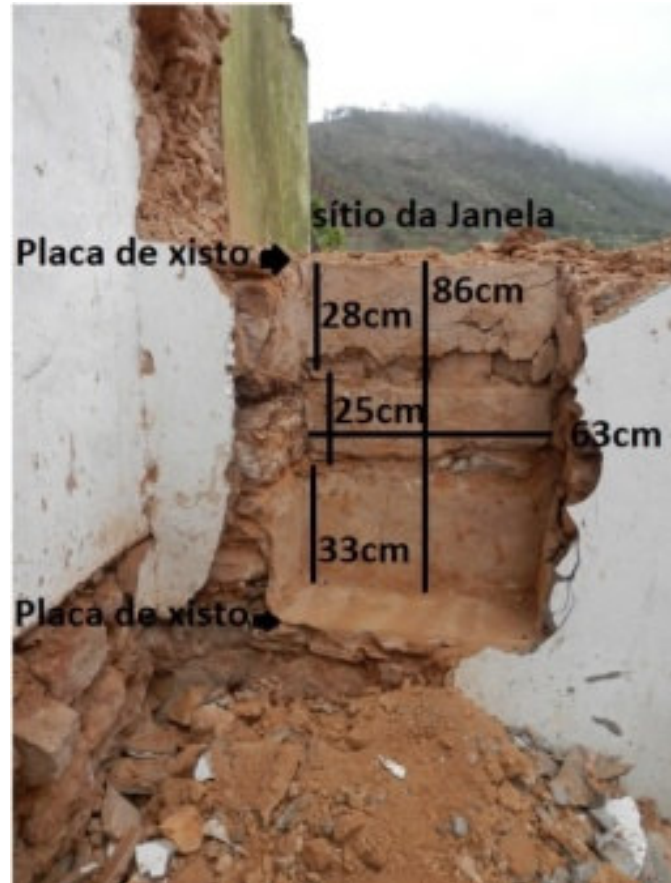
Figura 15. Cantareira embutida na parede, depois de limpa, e respetivas medidas.
