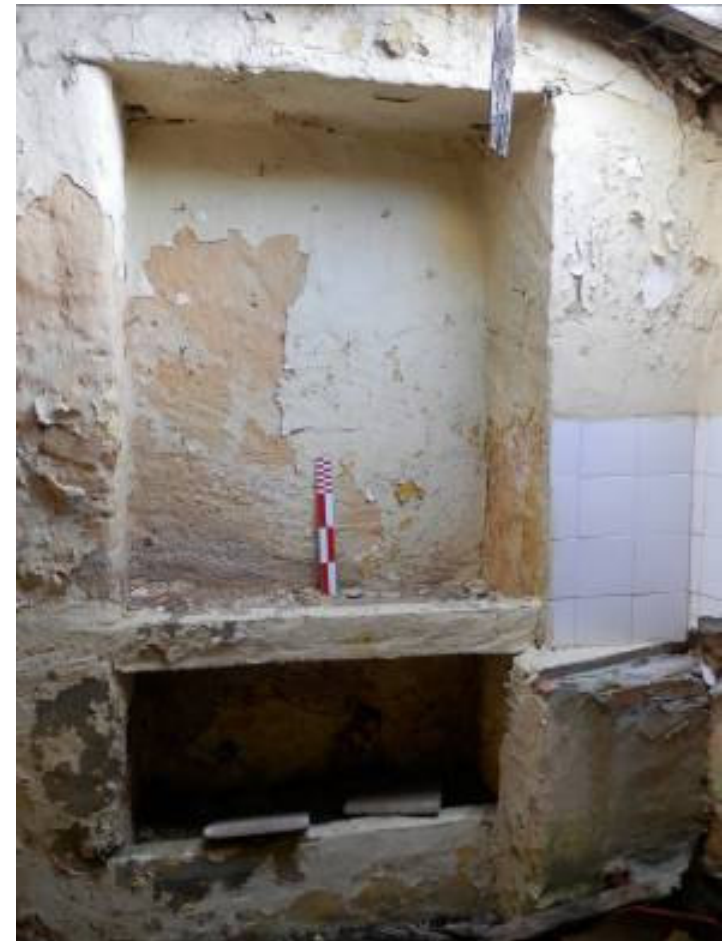
Figura 18. Ruína oriental, cantareira existente no compartimento da cozinha.
